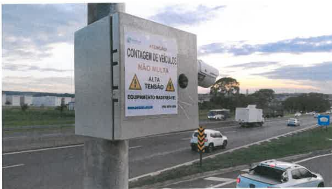
Figura 2a: Exemplo de Instalação de Câmeras de Monitoramento
