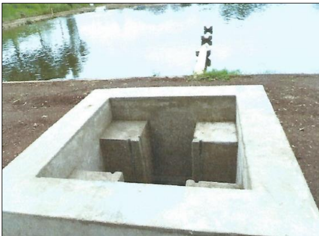
Figura LXXV – Caixa de entrada do esgoto bruto para a lagoa anaeróbia
