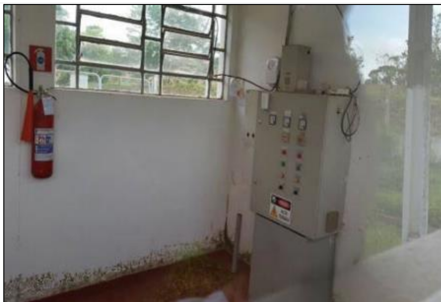
Figura XXXVII – Quadro elétrico de comando.
