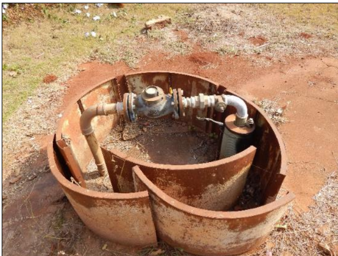
Figura LXVI – Detalhe do poço artesiano
