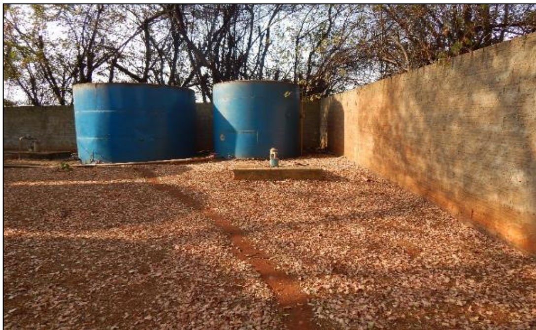
Figura LVIII – Reservatórios metálicos e poço artesiano
