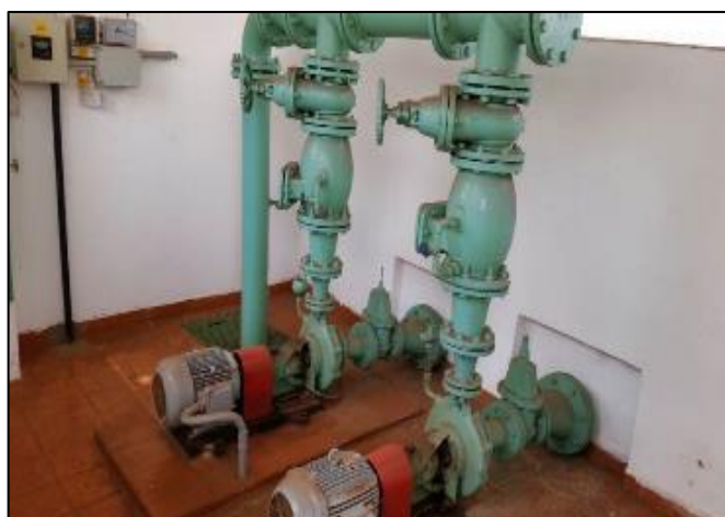
Figura XLVIII – Sistema de bombeamento do reservatório apoiado para o elevado
