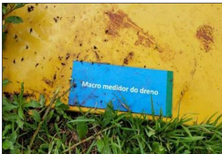
Figura XXXVIII - Caixa do macro medidor do poço dreno.
