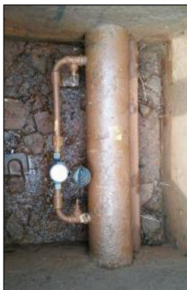
Figura XLIII – Macro medidor do poço dreno.
