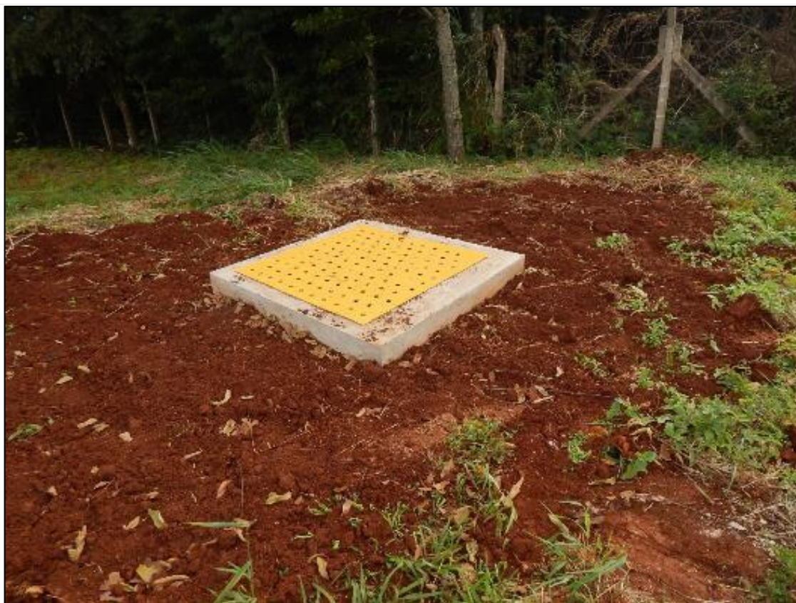
Figura LXXVIII – Entrada do esgoto bruto coletado na Penitenciária Municipal
