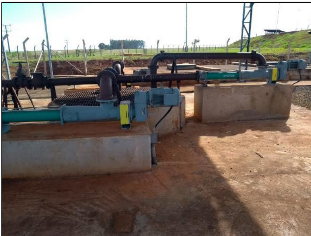
Figura LXXIX – Estrutura do conjunto elevatório no presídio municipal operado pela SABESP.
