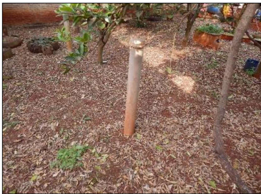
Figura LXXXIV – Fossa Séptica no condomínio Recanto das Águas
