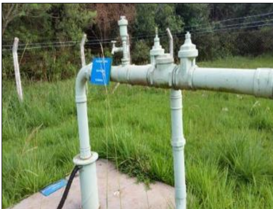
Figura XXXVI - Poço tubular profundo (P1).
