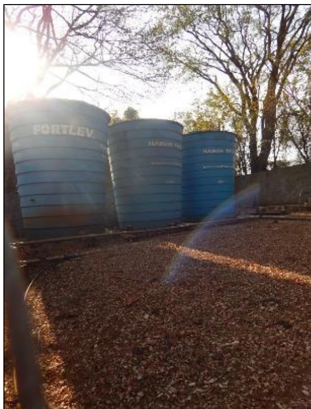
Figura LVII – Caixas d'água auxiliares para reservação
