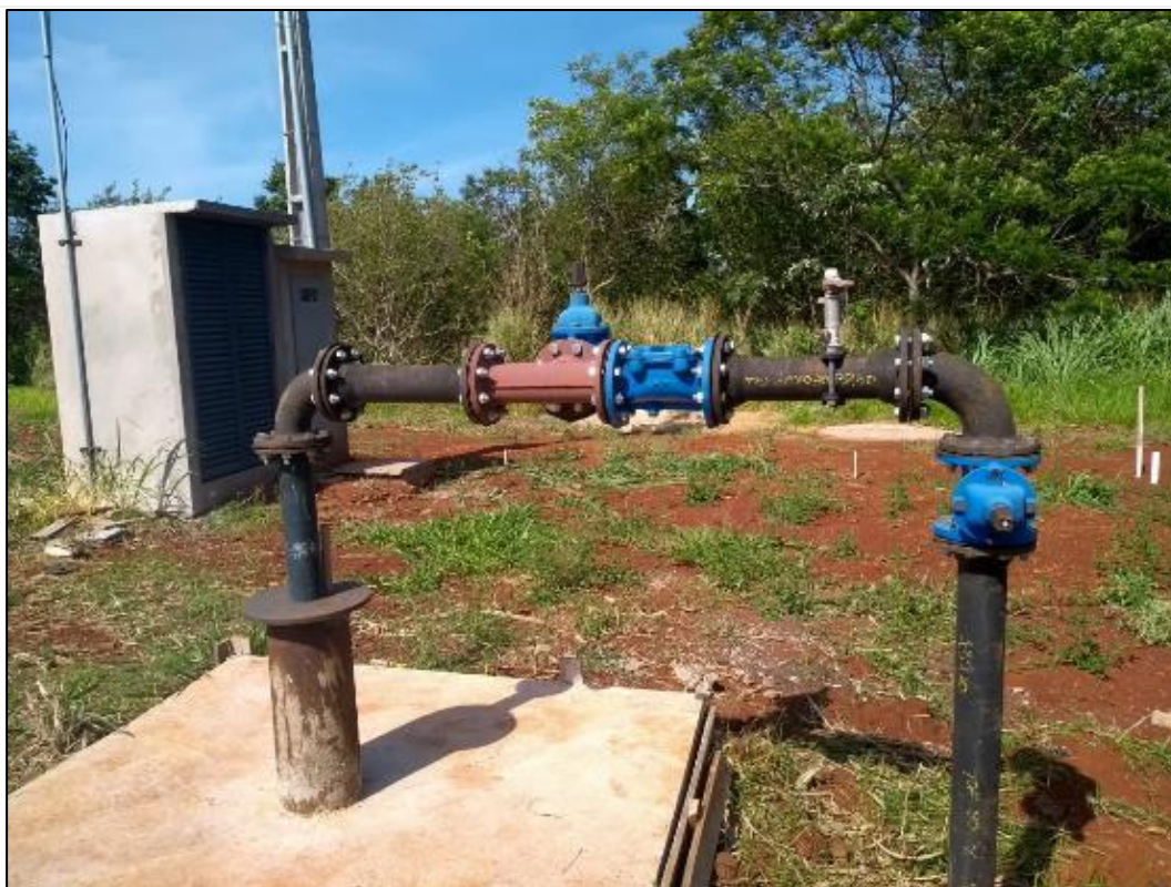
Figura XLI – Detalhe do Poço P4 com macromedidor de vazão
