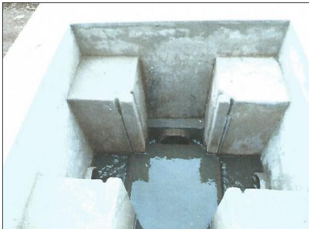
Figura LXXVI – Detalhe da caixa de entrada do esgoto bruto
