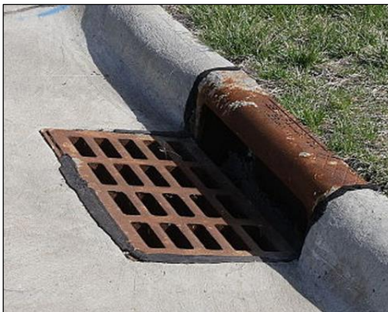
Figura CXXVII – Gradeamento em boca de lobo na sarjeta
