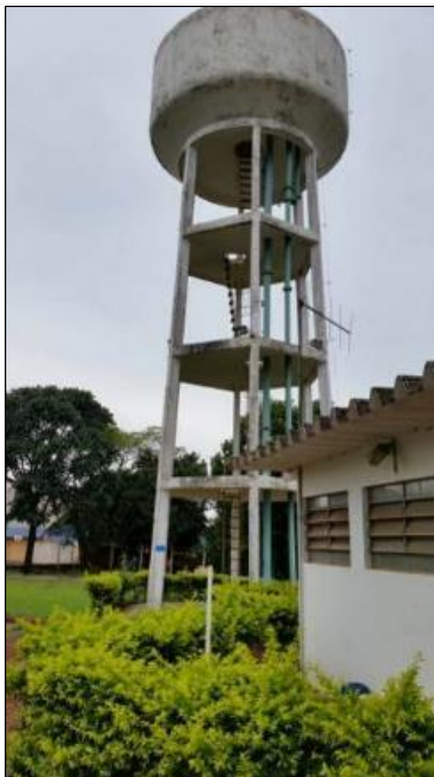
Figura LI – Reservatório elevado tipo taça.
