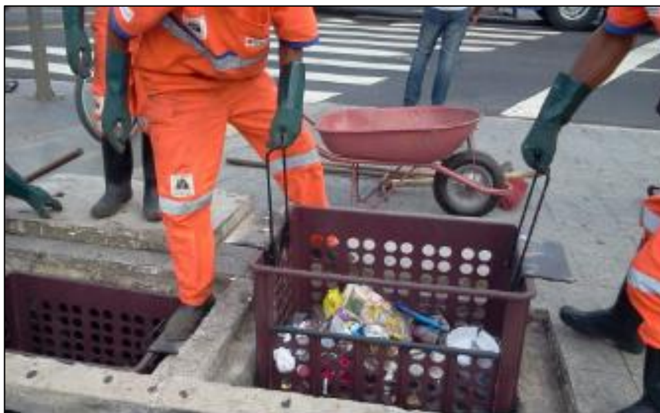
Figura CXXVI – Cestas acopladas às bocas de lobo
