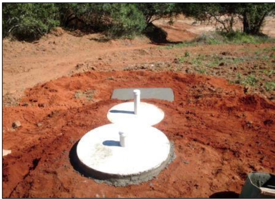
Figura LXXXI – Fossa Séptica utilizada no condomínio Água Azul
